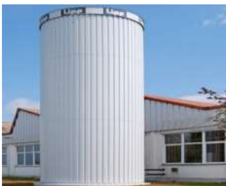
Ein 1.000m 3 Wärmespeicher wird typischer Weise direkt an die Heizzentrale gebaut. Das Bild zeigt einen solchen Wärmespeicher
